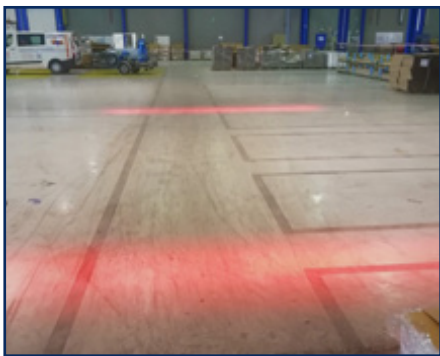
Muestra de luz real sobre el pavimento que delimita la zona de acción del puente grúa.
