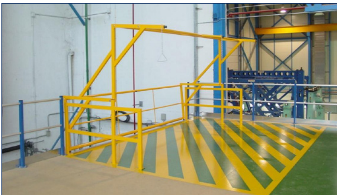
Barrera de seguridad anticaída
